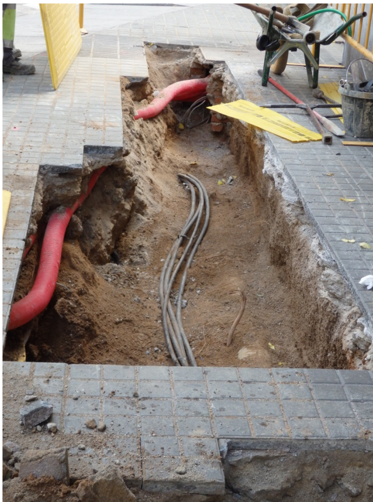
Vista de d'un tram de la rasa realitzada al carrer Comandant Benítez
